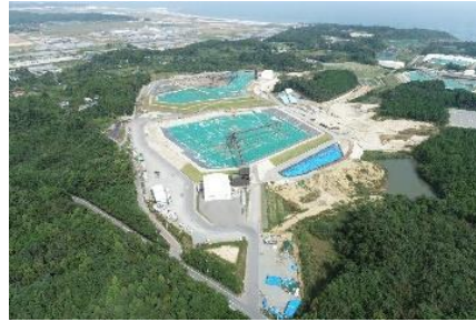
土壌貯蔵施設(双葉①工区)
