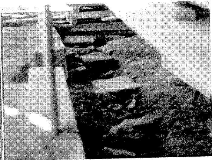
布石撤去完了（梁石を清掃したのち コンクリートを敷いて布石を据え直した）
