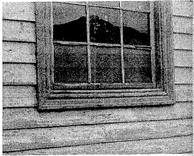
ベンキの剥離、窓枠の腐朽状態（南面）
